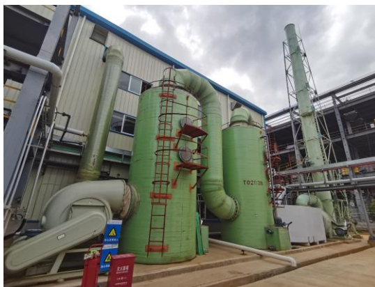
图 4.1-1 生产车间废气处理设施
